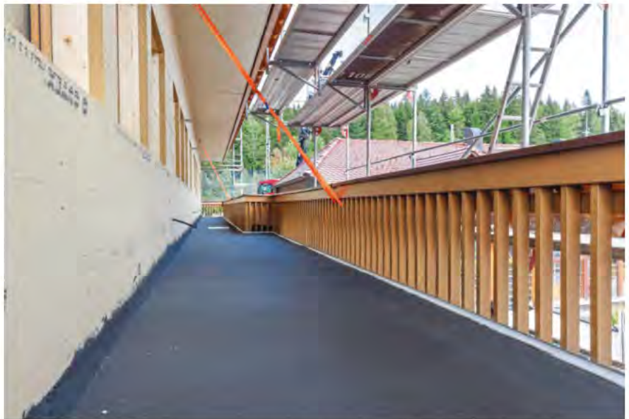
Zur dauerhaften Abdichtung der Balkone kam die Kombiflexabdichtung vollflächig auf den Untergrund.
