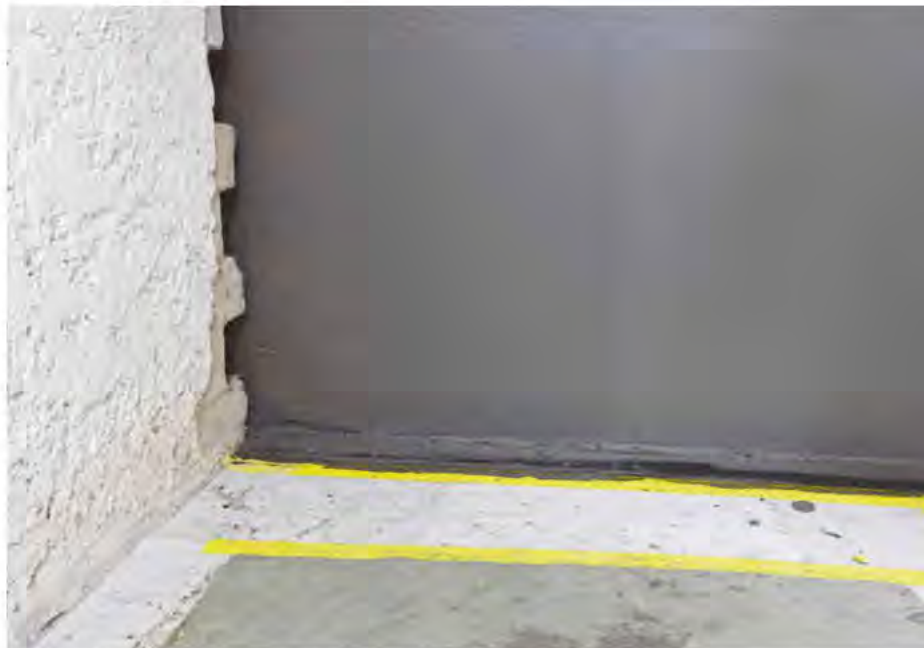
Die Wände waren vor der Kellerbodensanierung fachgerecht abgedichtet.
