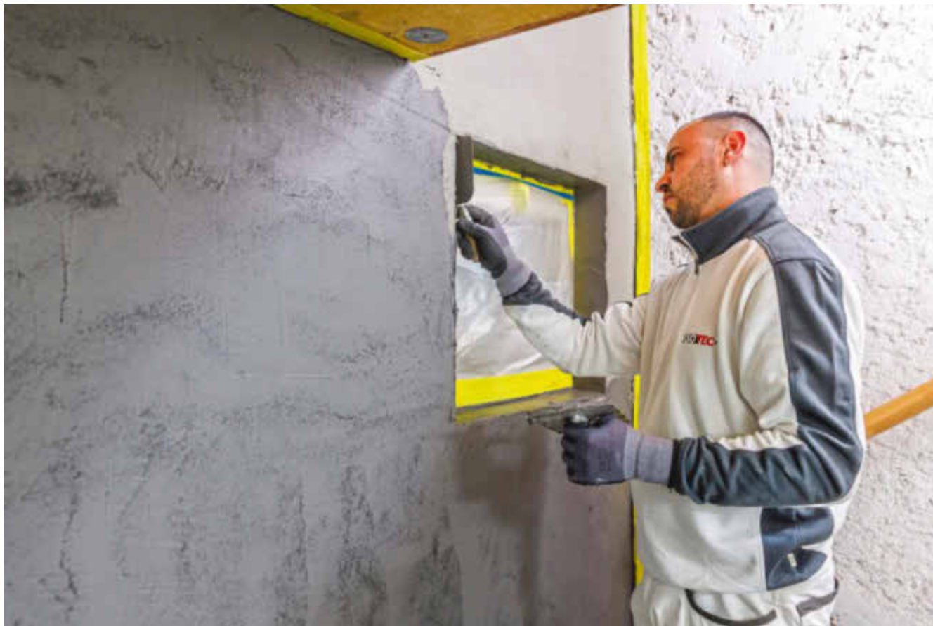
Um die Kellerwände abzudichten, kam die Kombiflexabdichtung in zwei Lagen zum Einsatz.
