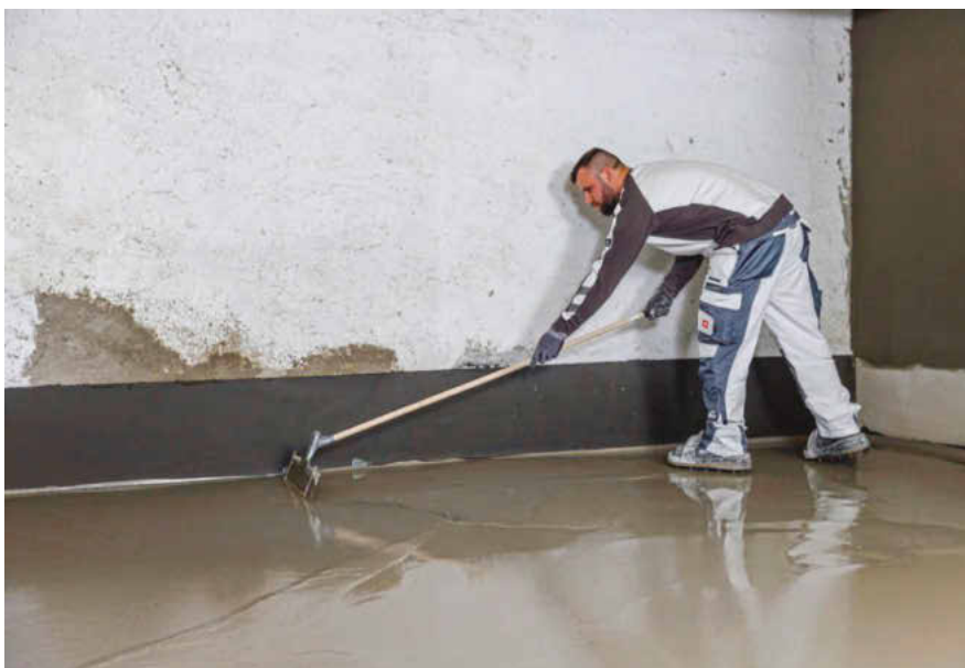
Der Boden erhielt eine spezielle Versiegelung und war nach vier Stunden schon wieder begehbar. Auch der Wand-Boden-Anschluss ist in die Abdichtung integriert.
